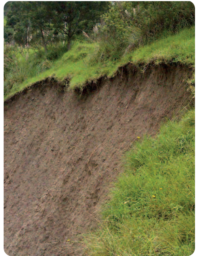
Foto 32. Derrumbe en canal de conducción, sector San Vicente, cantón Girón
