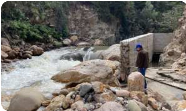
Foto 5. Muro de protección en captación del sistema de riego Las Nieves Chilpa Susudel, cantón Nabón, provincia de Azuay
