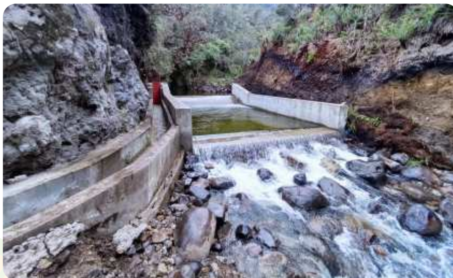
Foto 1. Captación tradicional, sistema de riego Hornillos II, cantón Nabón, provincia de Azuay
