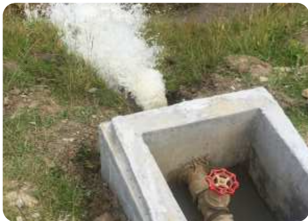
Foto 15. Válvula de purga en funcionamiento
