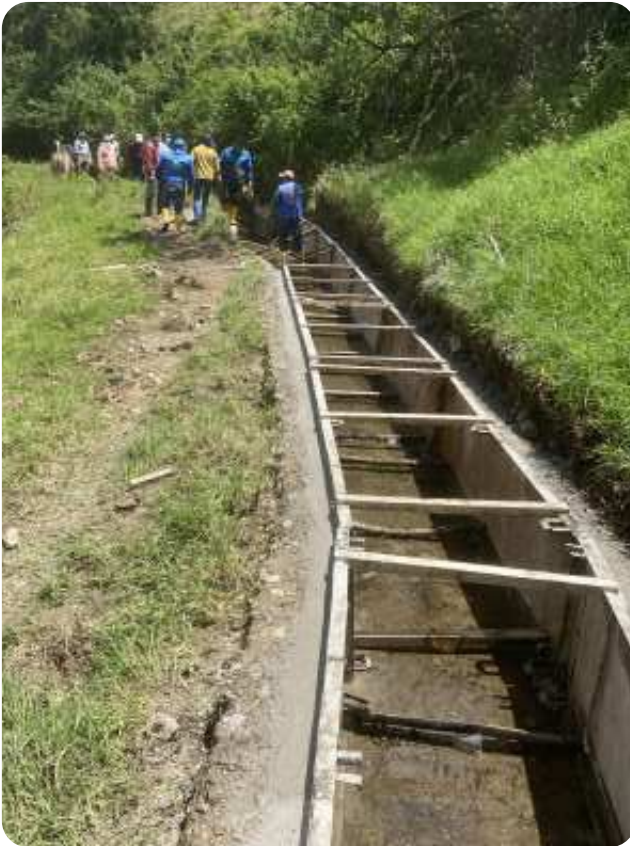
Foto 12. Revestimiento de hormigón de canal de riego Severo Espinosa Valdiviezo, cantón San Fernando, provincia de Azuay
