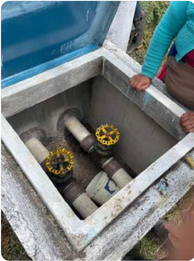
Foto 25. Válvulas de control
