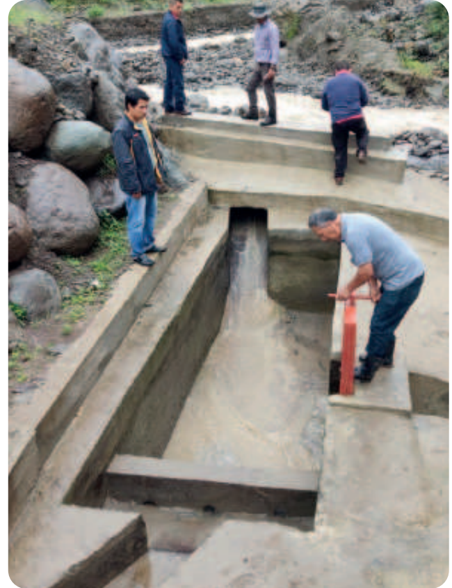
Foto 9. Desarenador del sistema de riego Ovejerías, parroquia Abdón Calderón, cantón Santa Isabel, provincia de Azuay
