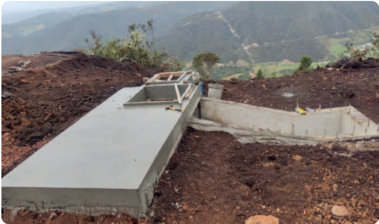
Foto 20. Tanque de carga, sistema de riego Hornillos II, cantón Nabón, provincia de Azuay
