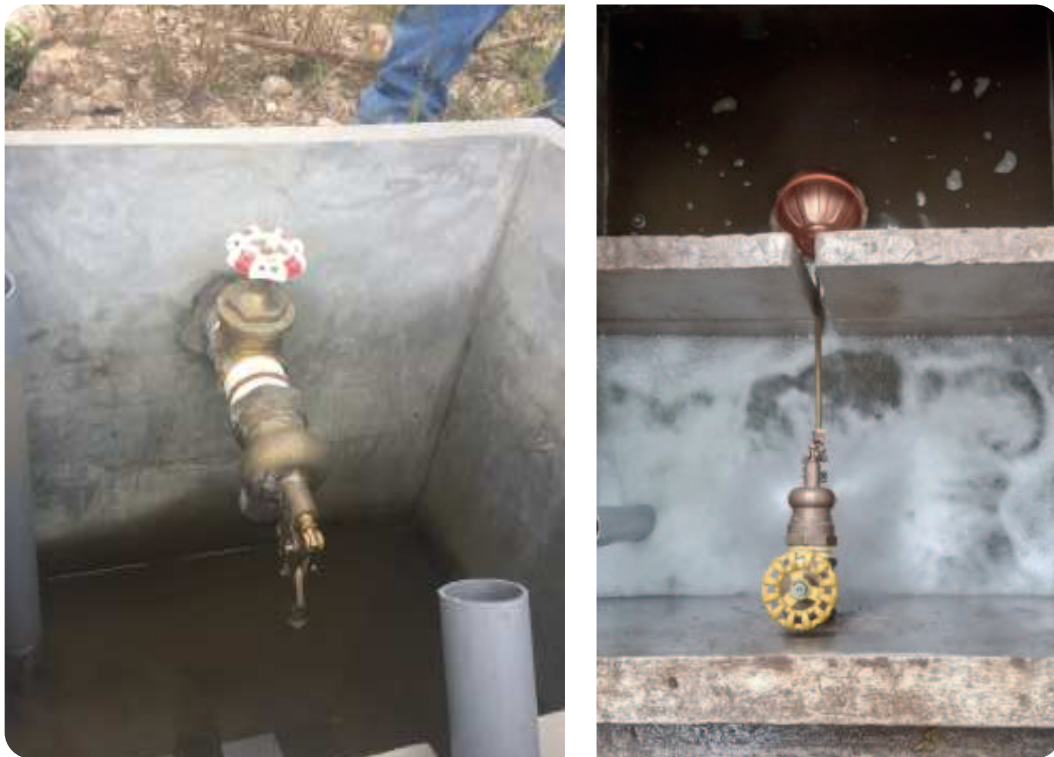
Foto 21. Tanques rompe presión con válvula flotadora
