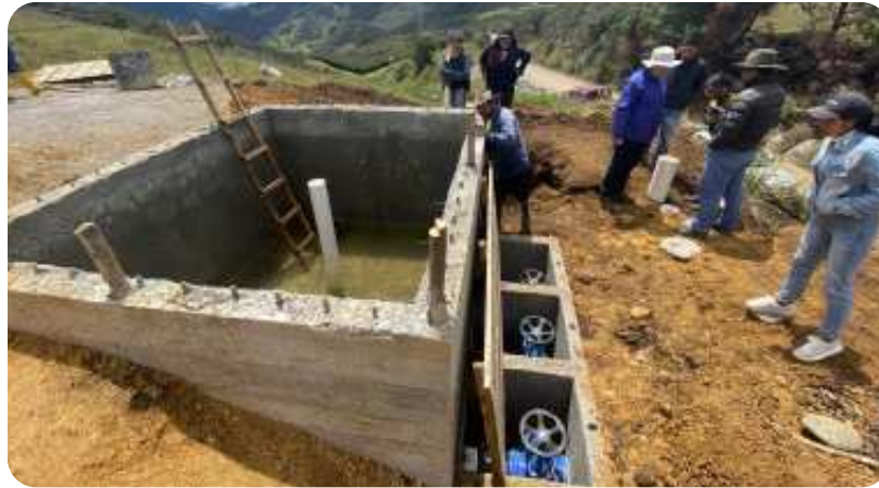
Foto 22. Tanque de distribución de Pinllo. Divide agua a diferentes sectores del sistema de riego Cerro Negro Churuco, cantón Sigsig, provincia de Azuay
