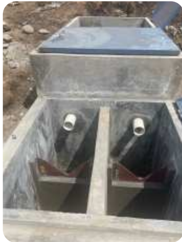
Foto 23. Tanque distribuidor de caudales con vertederos de control
