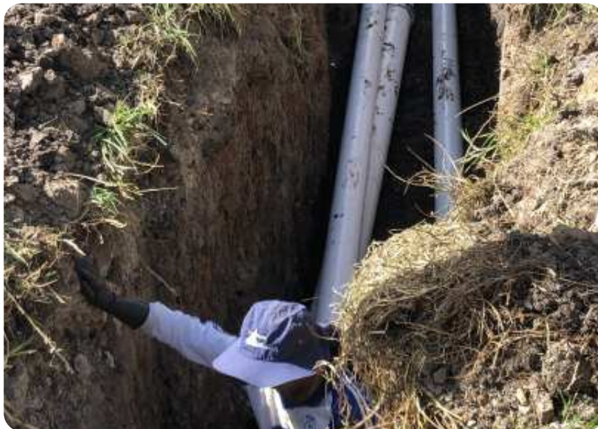
Foto 19. Tubería de salida de sifón y distribución a diferentes sectores del sistema de riego Cerro Negro Churuco, cantón Sígsig, provincia de Azuay
