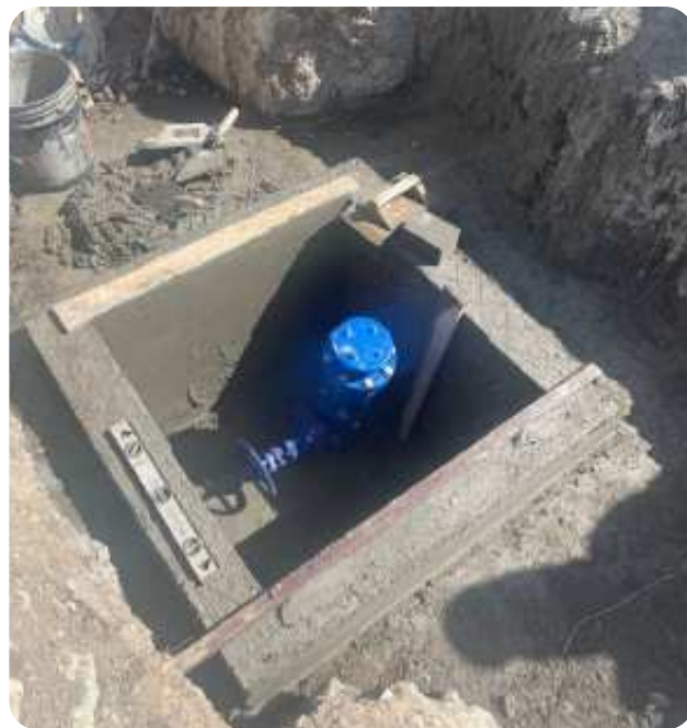
Foto 16. Válvula de aire
