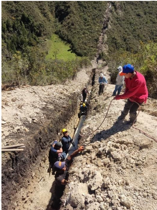
ILUSTRACIÓN 2. SISTEMA DE RIEGO HORNILLOS II – NABÓN, NABÓN.
