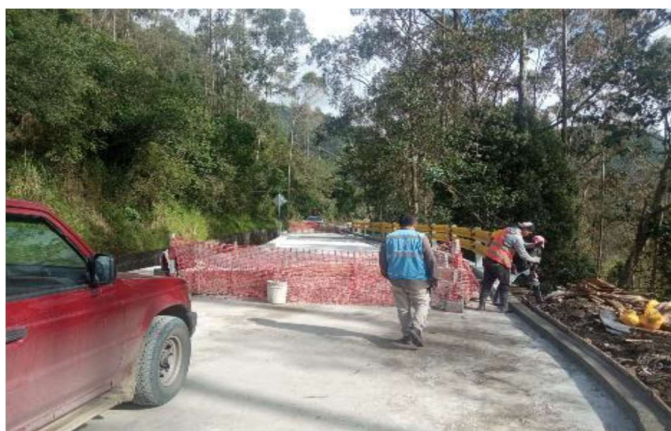
Pavimentación de la vía Dutasay - Saucay y mantenimiento del puente del río Chacayacu, Parroquia Chiquintad – Cantón Cuenca.
