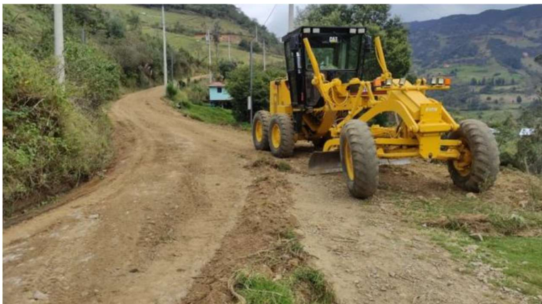
Proceso de colocación, hidratación y compactación de material de lastre para el Mantenimiento Vial Delegado 2021. Parroquia Delegsol Cantón Sigsig.
