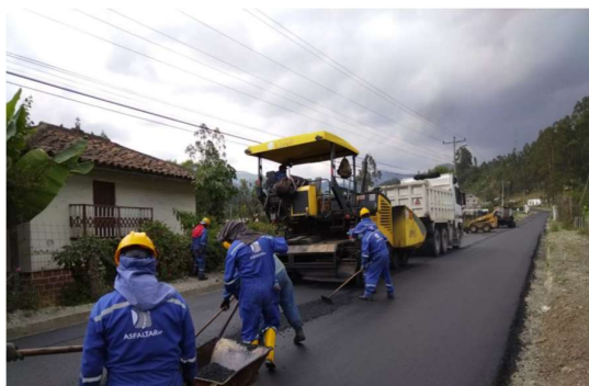
Mejoramiento a nivel de carpeta asfáltica de 2" en la vía Ochoa León- Checa – Cantón Cuenca Longitud 3,3 km – 01/03/2022.
